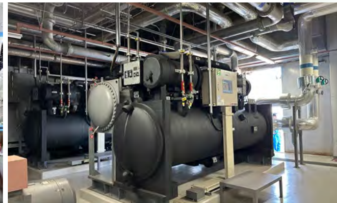
エネルギー効率が改善された能登工場の冷凍機
