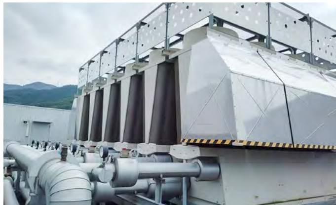
滋賀プロダクトサプライセンター 空冷チラー
