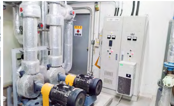
滋賀プロダクトサプライセンター 冷水バックアップ循環ポンプ
