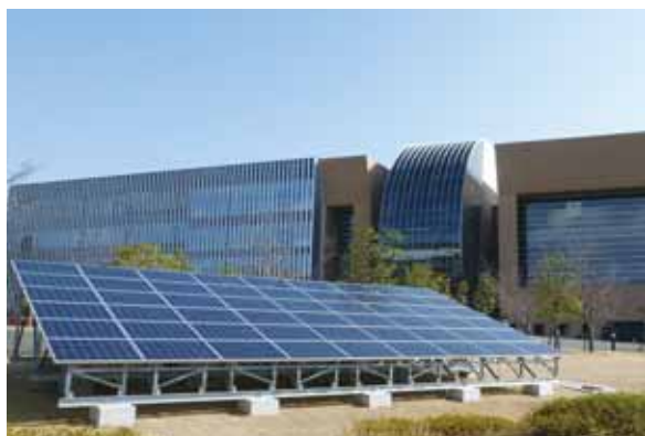
奈良研究開発センター 太陽光発電設備
