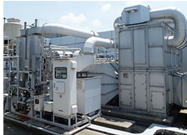
奈良研究開発センターの有機溶剤回収装置
